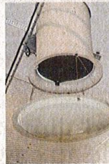
Les coupelles des cheminées de ventilation sont équipées d'un kit anti-perchage.
